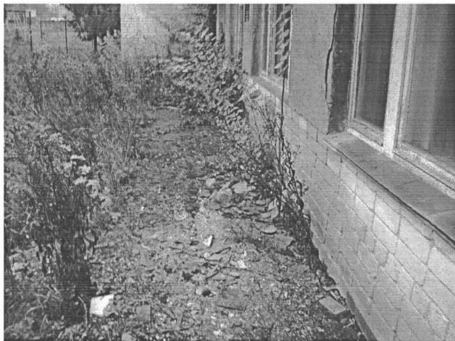
Вимощення зруйноване, що приводить до замокання основ фундаментів
