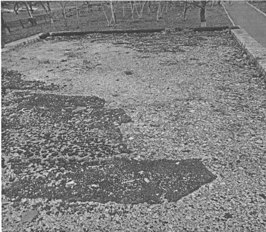
Зруйнований покрівельний шар на будівлі
