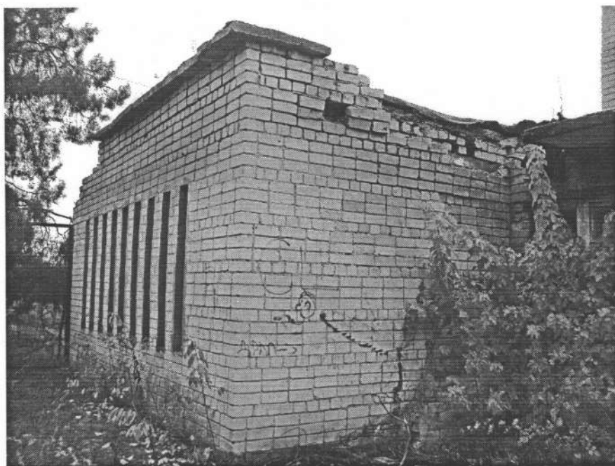
Деформації карнизу і обрушення цегляної кладки
